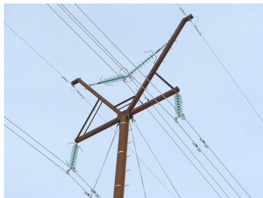
شکل ۷ - تیر برق انتقال نیرو در Torne River Valley (Torinijokilaakso) از فولاد مقاوم به خوردگی جوی ساخته شده است.
