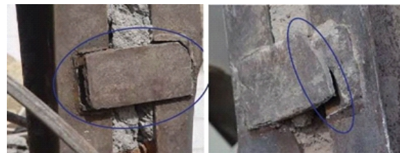
شکل ۱- نمونه هایی از باز شدن اتصالات جوشی در اثر زلزله [۳].
